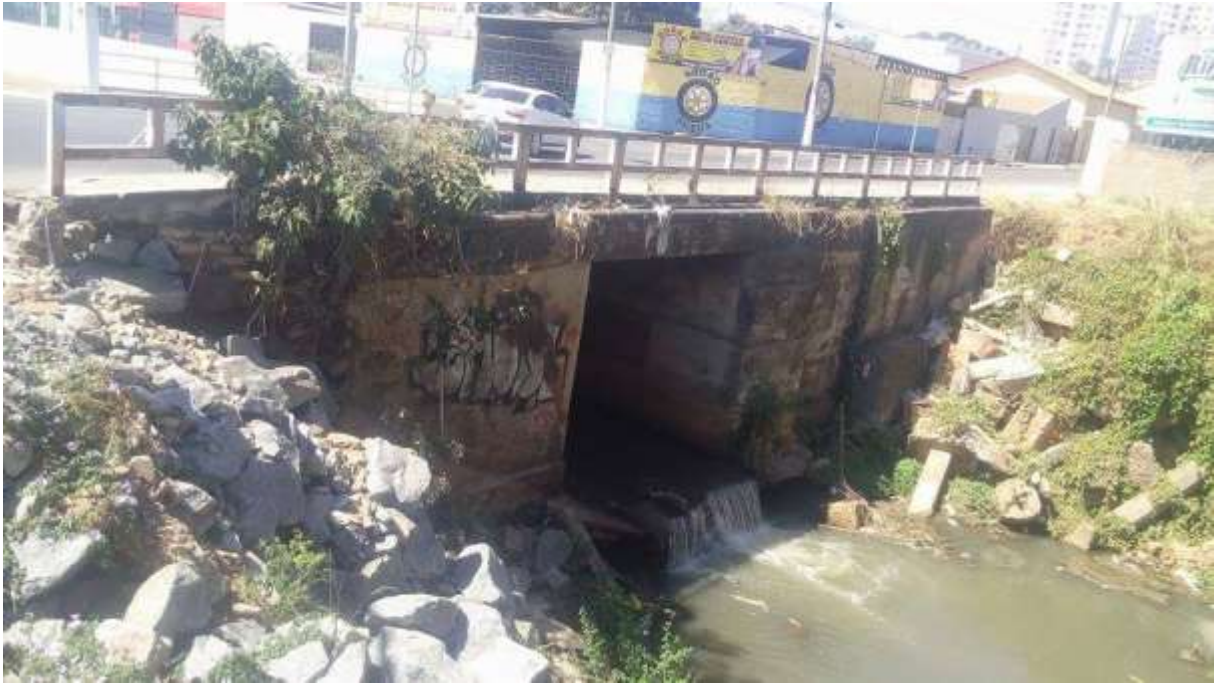
Foto 01 – Fim da canalizado do ribeirão Pirapitinga localizado ao lado do Posto Gaúcho. - Município de Catalão (GO). Autor: M. G. Viana (2017).
